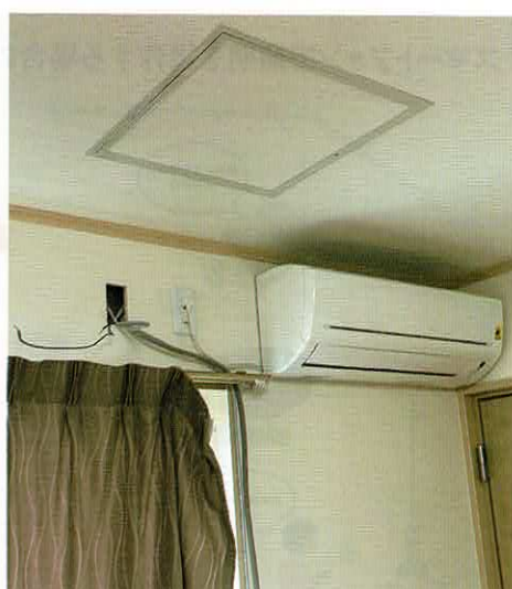
既存の古いタイプの製品でもJEM-Aに対応していればシンプルジェットでIoT化できる(千葉誠モデルハウスの施工中の様子)
