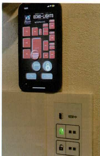
電子錠の開錠の様子。タッチパネルとアプリの画面の開閉表示が連動する(千葉誠モデルハウス)
